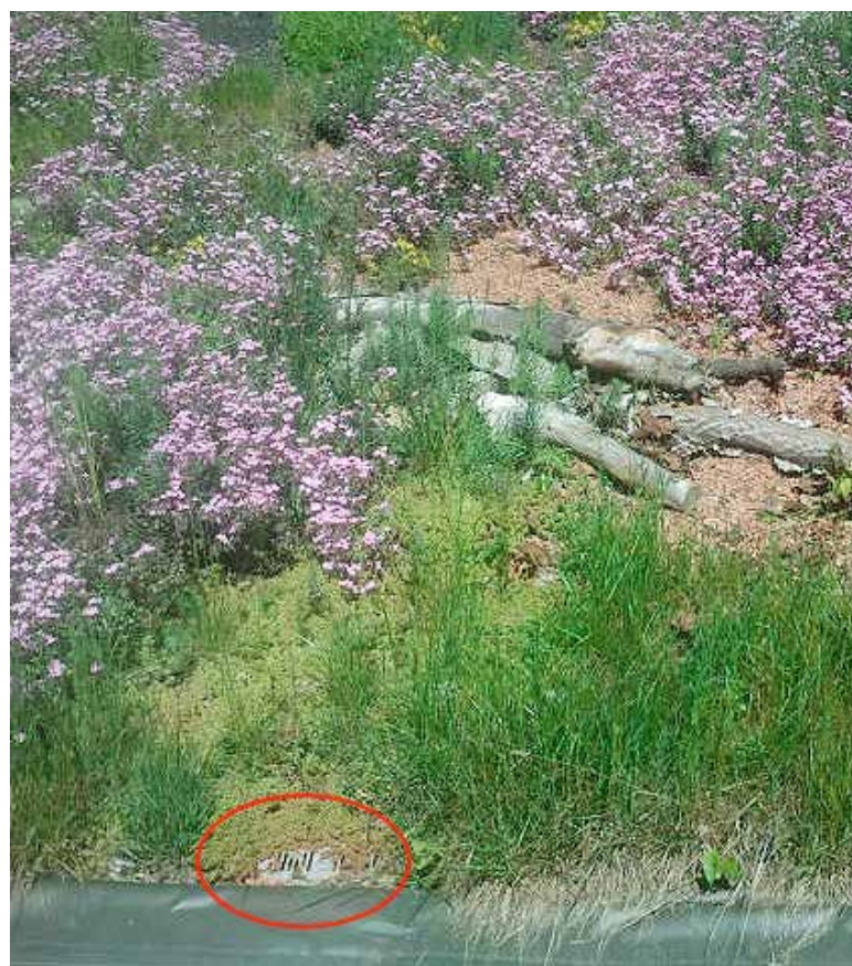
Sortie de drainage obstruée par la végétation et le substrat. ©Eva Robausch
