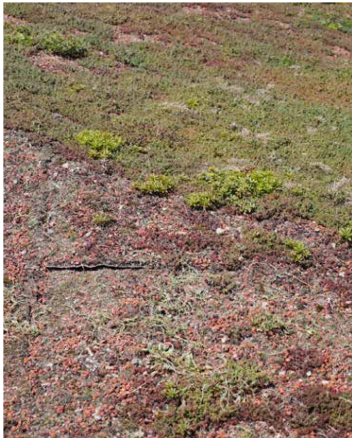
Erosion du substrat sur une toiture de sedum et de mousse. ©Jonatan Malmberg
