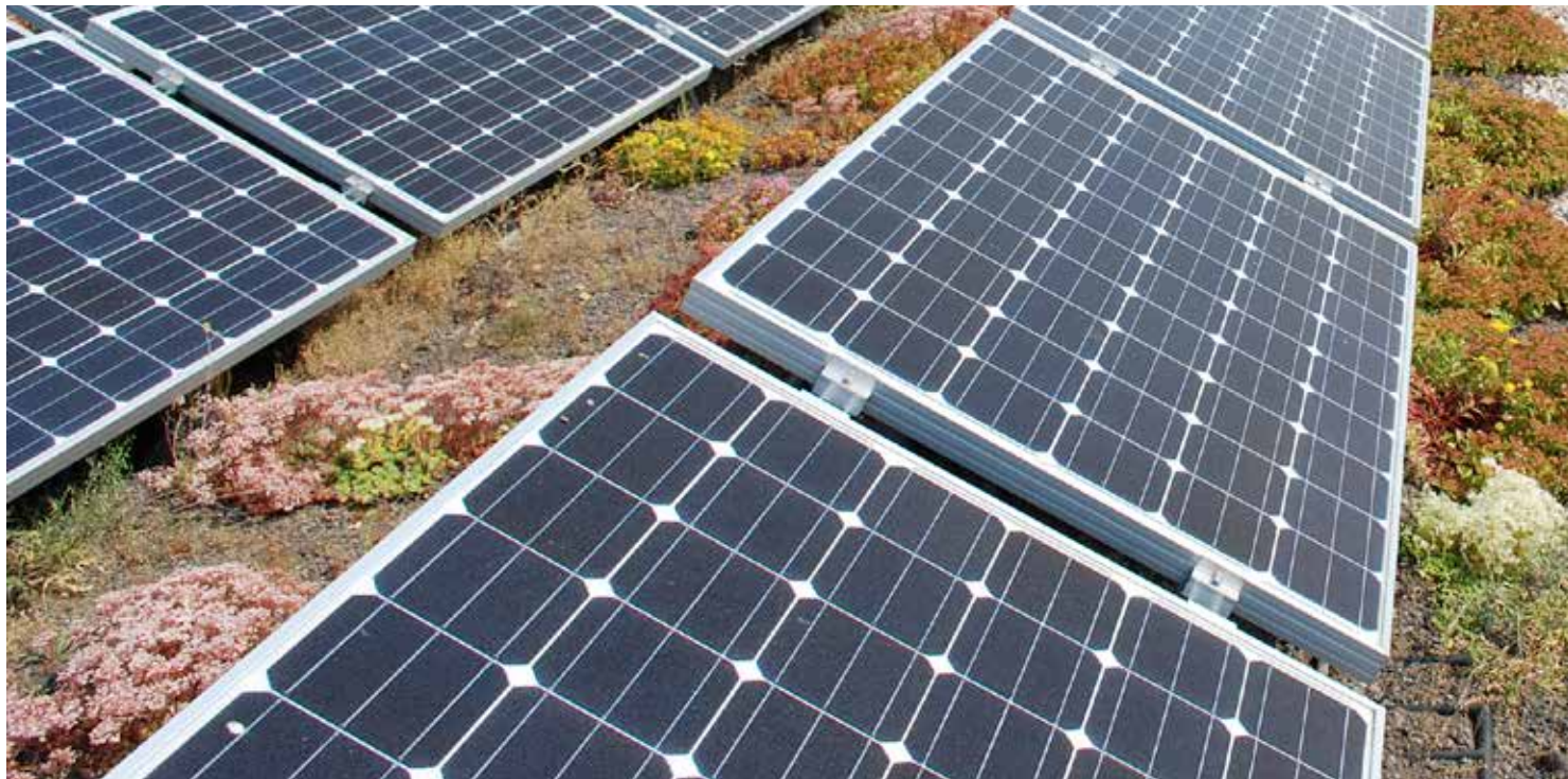
Panneaux solaires installé sur une toiture végétale
