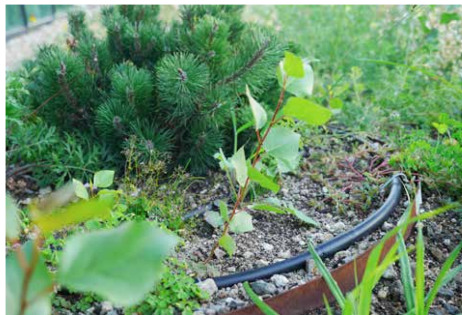
Les pousses d'arbre doivent être enlevées. ©Jonatan Malmberg
