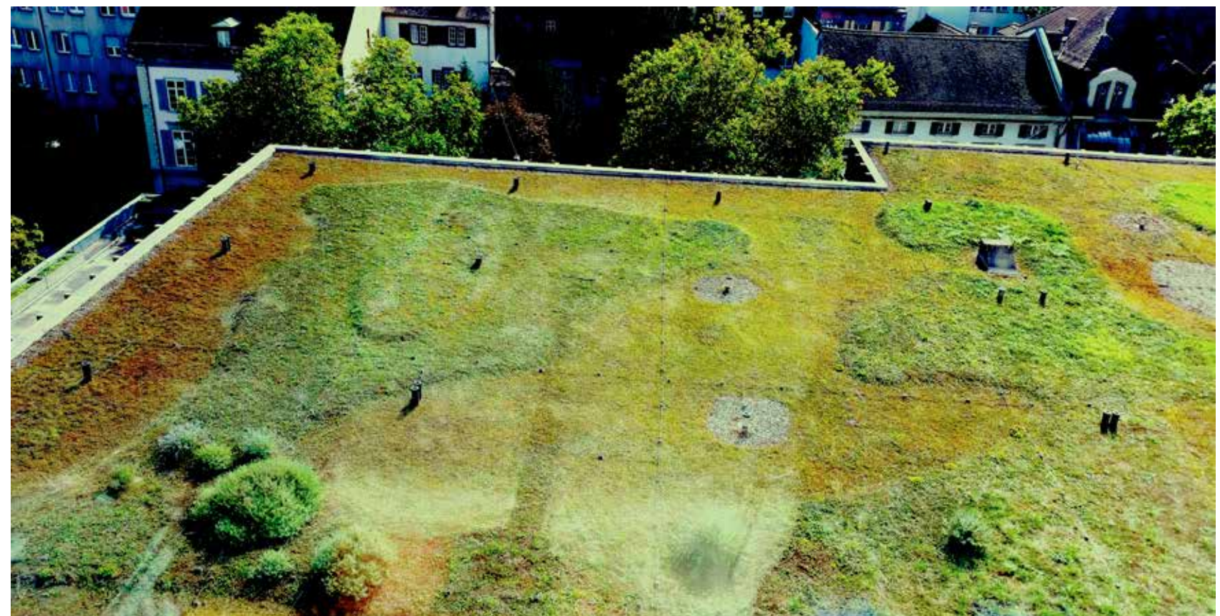
Variété de végétation grâce à des variations de profondeur de substrats. ©Nathalie Baumann
